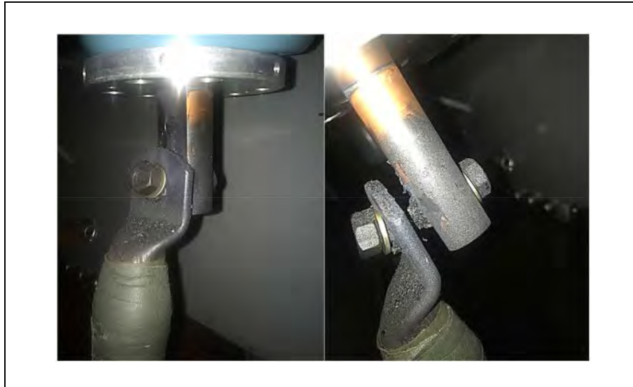
شکل (پ-۲): محل اتصال هادی به بوشینگ فاز V ترانسفورماتور
