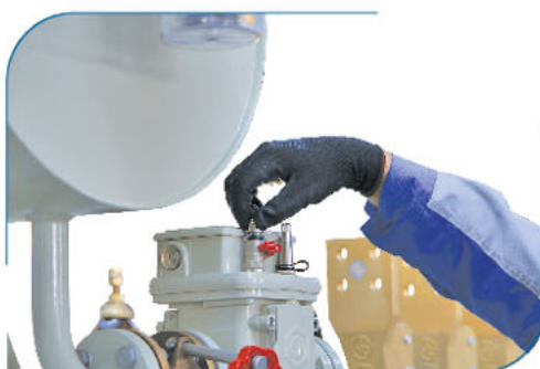
شکل ۳-۱۸ نحوه هواگیری رله‌ی بوخهلتس
