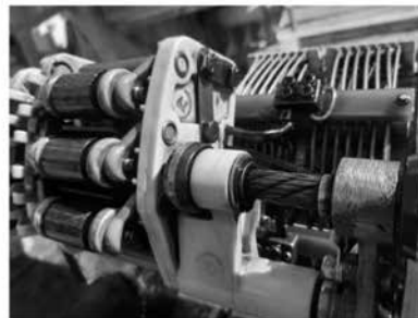
شکل هفده: کنترل کنتاکت‌ها، فنرها، کابل‌های اتصال
